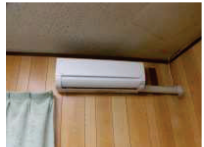
新しくなったエアコン
